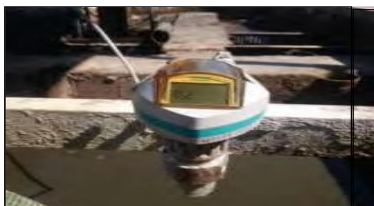
ETP inlet Effluent Flow meter
